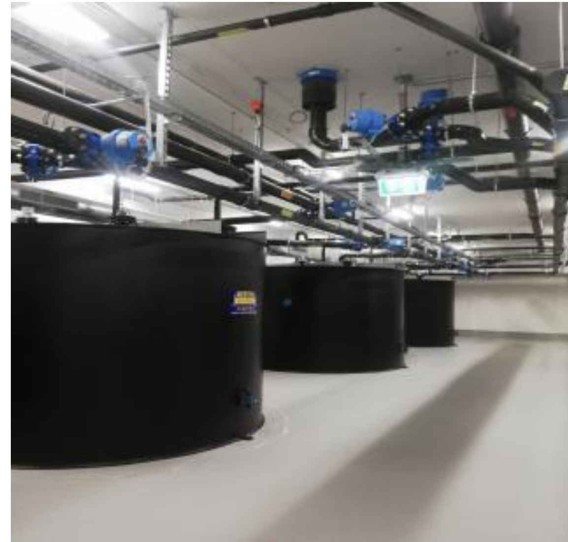
Cuve (remplissage, décroissance)
